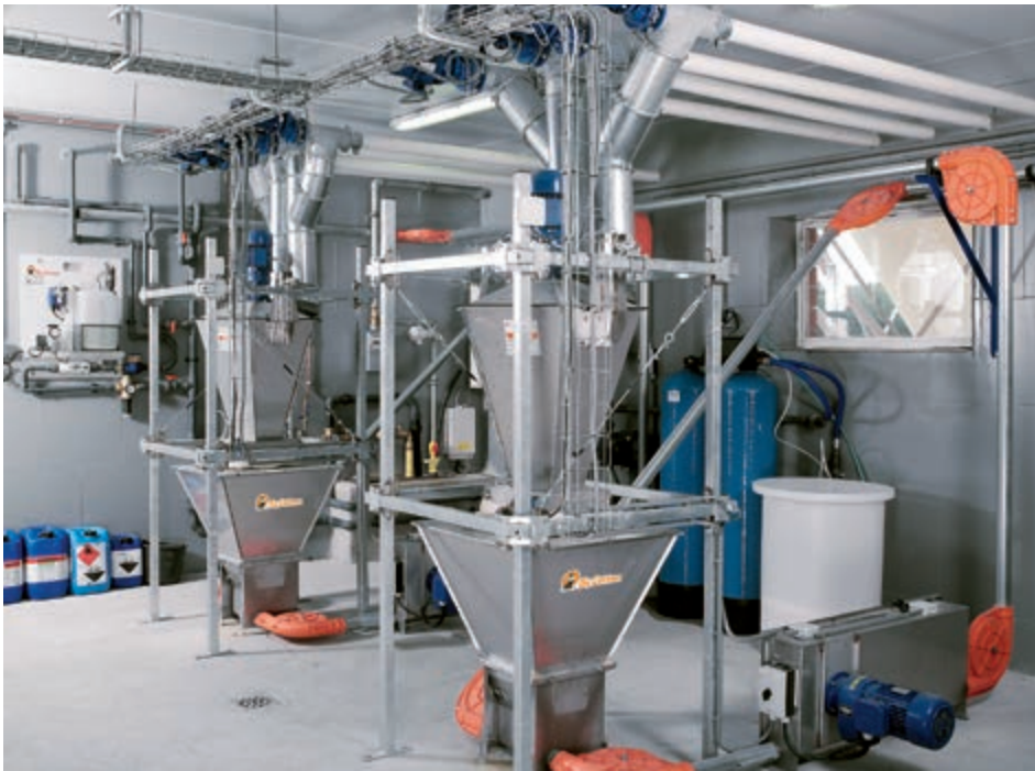
DryExactpro – кормовая кухня: 2 установки, каждая с одной закольцованной кормолинией
